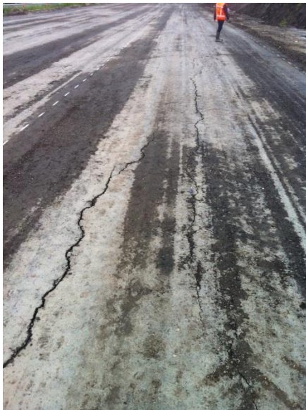
Schade door vervormingen ondergrond
