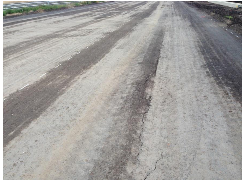
Schade door overbelasting van de fundering in de uitvoeringsfase
