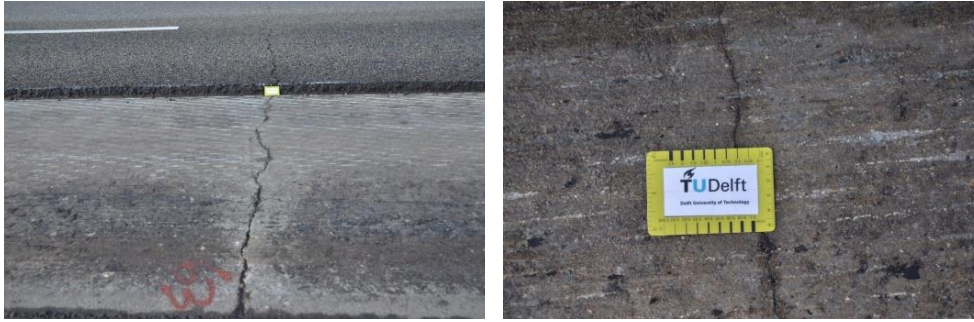
Figuur 6. Scheurwijdten in DGB-verharding A5; links: wijde scheur met reflectiescheur in ZOAB-deklaag; rechts: fijne scheur zonder reflectiescheur.
