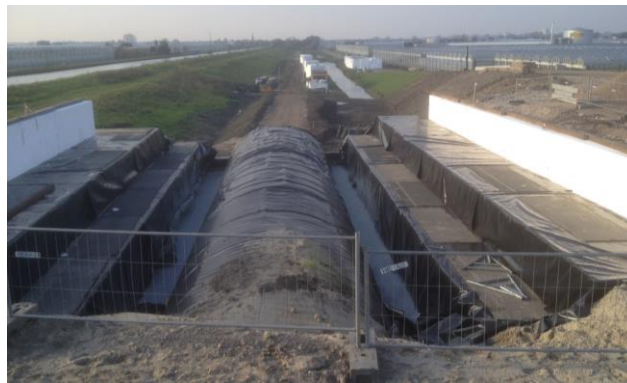
Figuur 5 De afedekte gegolfde staalplaten en het gedeeltelijk gestorte schuimbetonmassief van de fietstunnel onder de Veilingroute (N222)
