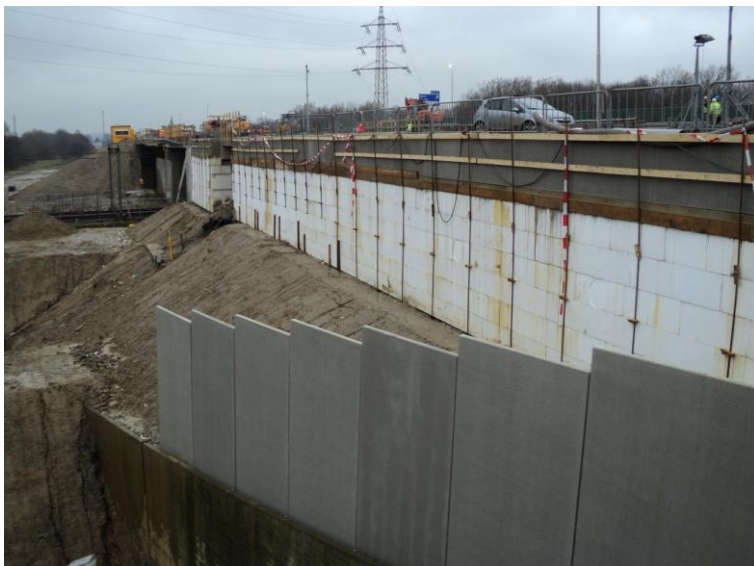
Figuur 2 De snelwegverbreding van A76 met de nog niet afgedekte EPS zijkant; het EPS-pakket is tot 4 m hoog boven de taludlijn opgestapeld; het ingekorte talud is ondersteund met een bestaande keerwand. De nieuwe betonnen wand op de voorgrond heeft enkel een afscherpende functie voor de EPS-constructie bij calamiteiten vanaf het Chemelot terrein.
