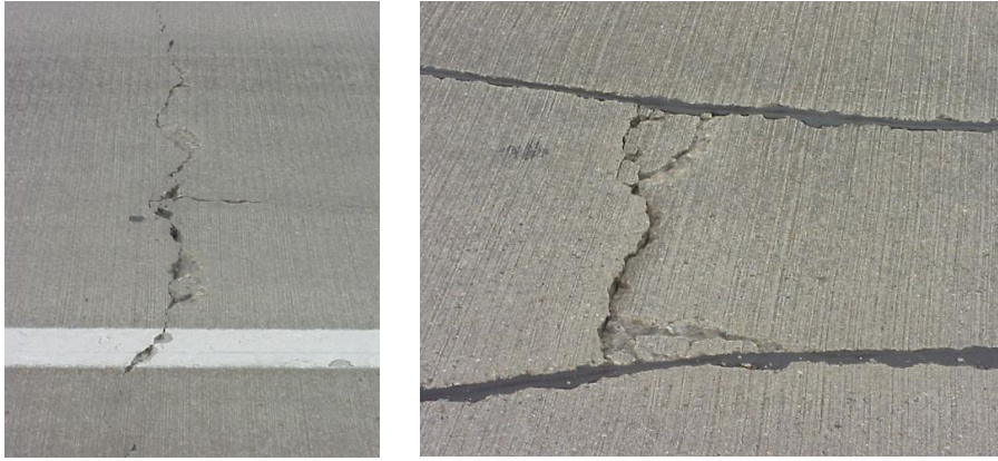
Figuur 5 scheuren in betonplaten A73
